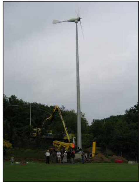
Impianto minieolico della potenza di 20kWp realizzato a Monterenzio (BO)
