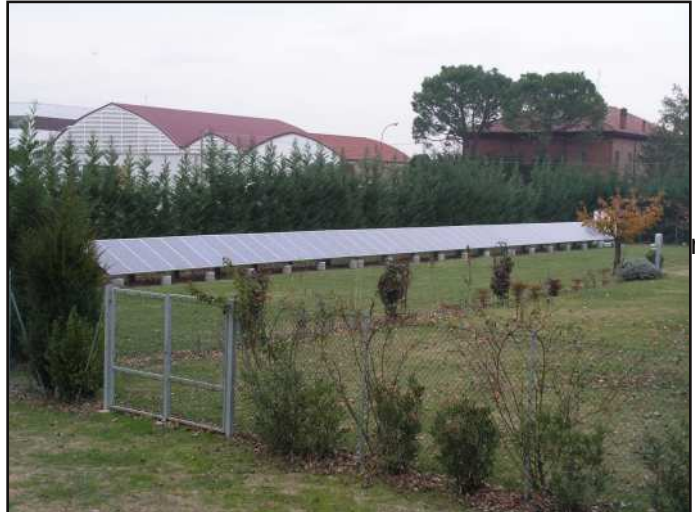
Impianto fotovoltaico della potenza di 12kWp realizzato a Cotignola (RA)
